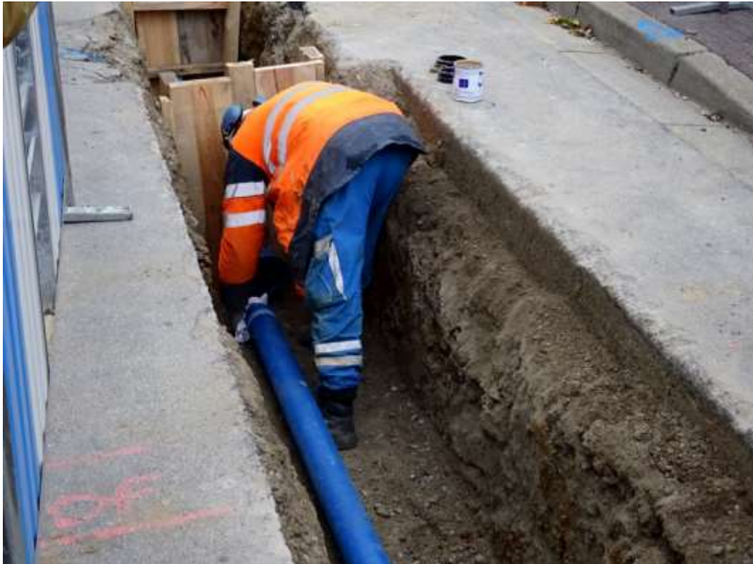
Figure 22 Emboîtement de deux tuyaux en fonte, chantier en région parisienne (photo équipe GESPARE 2019)
